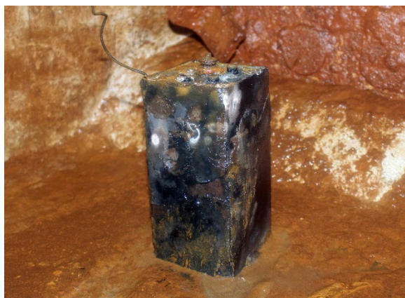
Fig. 27 – Batteri, formentlig til telefonsystemet. Foto: Achim Otto, 2019
