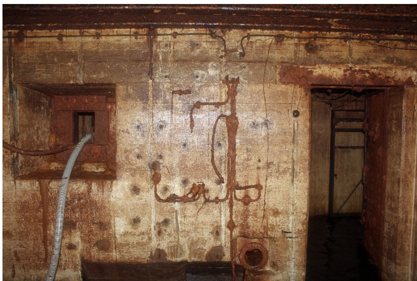
Fig. 20 – Væg med bolte og kabler efter telefonsystemet. Foto: Achim Otto, 2019
